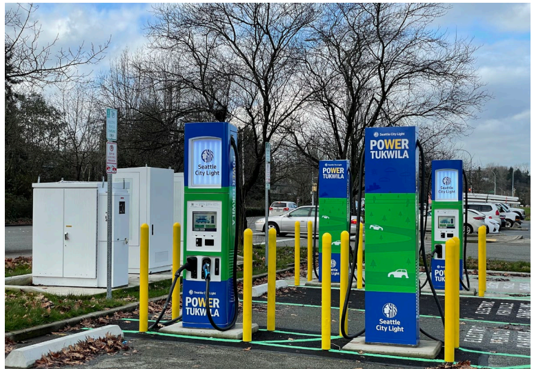
Các bộ sạc EV do Seattle City Light sở hữu và vận hành ở Tukwila, Wash.
